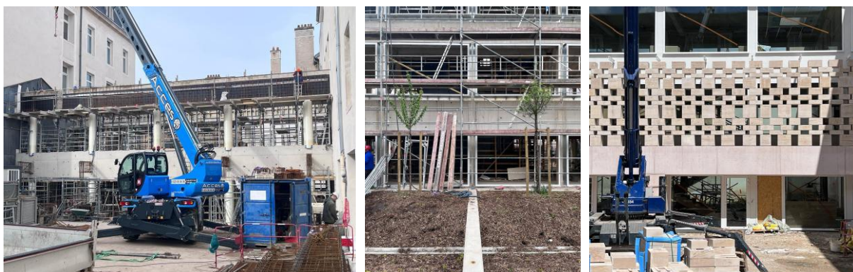
Démolition et reconstruction du bâtiment I donnant sur un patio végétalisé (crédit : Vulcano + Gibello Architectes)
